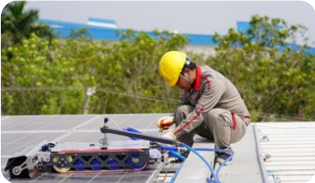
Vận hành hệ thống NLMT áp mái cho đối tác Green Yellow tại 35 Tỉnh với tổng công suất 70mWp
