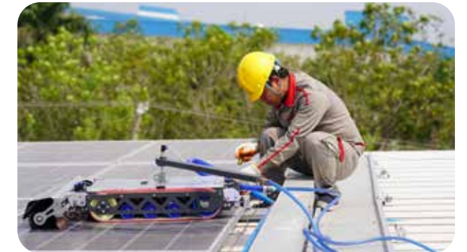
Vận hành hệ thống NLMT áp mái cho đối tác Green Yellow tại 35 Tỉnh với tổng công suất 70mWp
