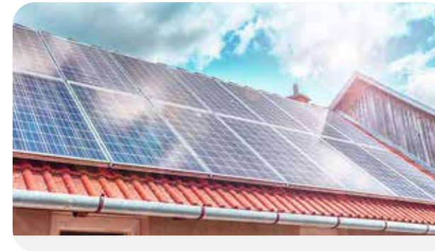
Vận hành hệ thống điện NLMT áp mái cho đối tác CME Solar tại 8 tỉnh (20.6 MWP)
