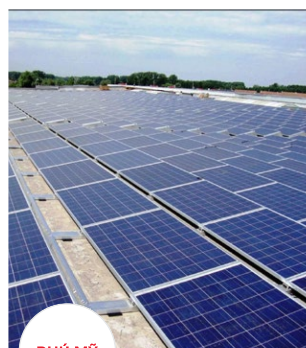
Dự án điện NLMT Phú Mỹ, Bình Thuận (5 MWP)
