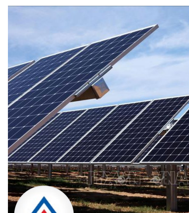
Dự án điện NLMT Thăng Long Group, Ninh Thuận, Bình Thuận, Phú Yên (10 MWP)
