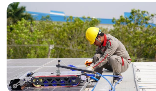
Vận hành hệ thống NLMT áp mái cho đối tác Green Yellow tại 35 tỉnh
