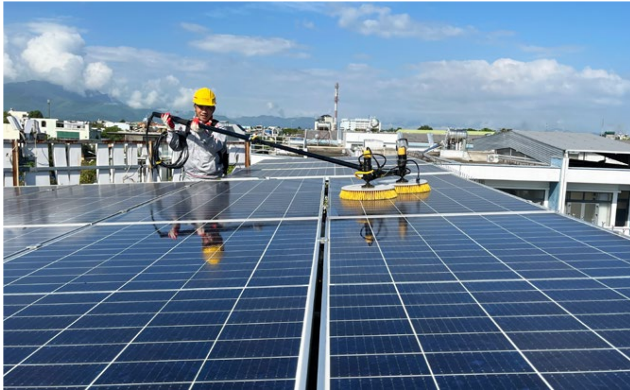
GIÁM SÁT VÀ BẢO TRÌ HỆ NLMT ÁP MÁI \approx 13 MWP SKYX (TRUNG + NAM)
