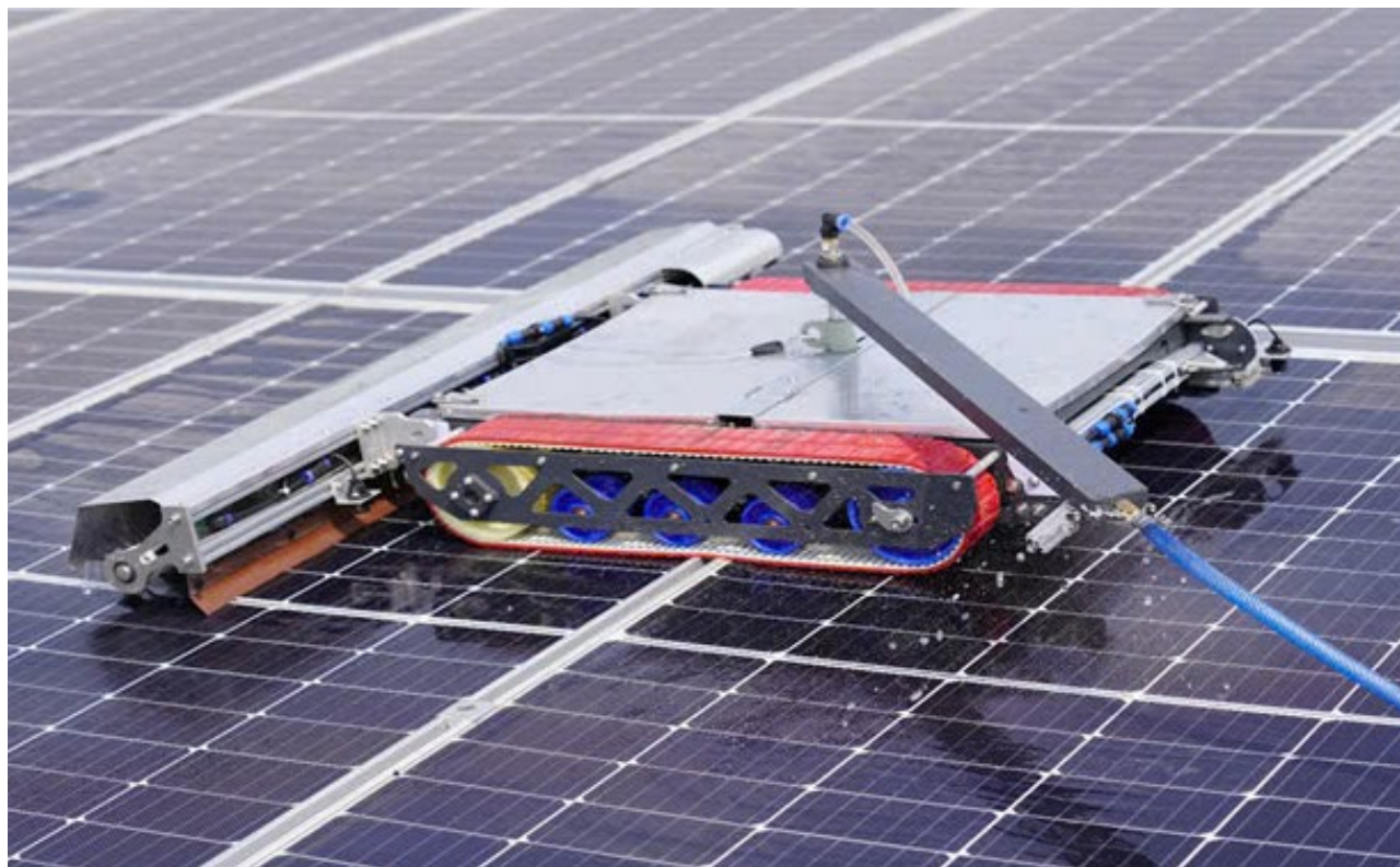
VẬN HÀNH HỆ THỐNG ĐIỆN NLMT ÁP MÁI ALCAMAX PACKAGING: 1MWP – MIỀN NAM
