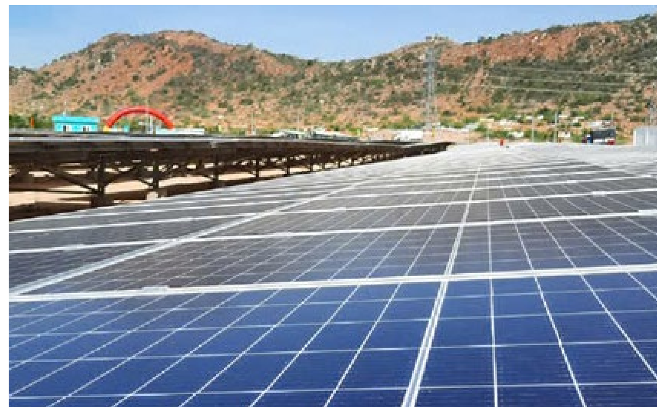
BẢO DƯỠNG HỆ THỐNG NLMT V-KOM QUẢNG BÌNH (1 MWP)
